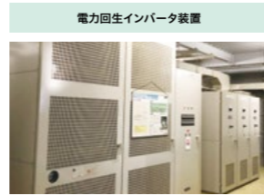
導入場所：羽田変電所
